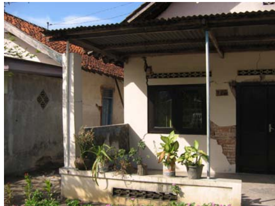
Gambar 5. Rumah berstruktur pasangan bata tanpa tulangan, kategori kerusakan D3, Tlogo, Prambanan (Klaten), S7.75259° E110.49550° IMG_6852
