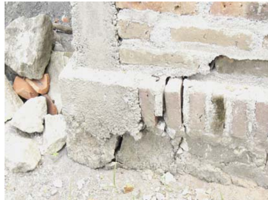
Gambar 28. Pergeseran di sepanjang pertemuan antara dinding/pondasi, Tegal Kebong Agung, Imogiri (Bantul) S7.93434° E110.36667°, CIMG1769
