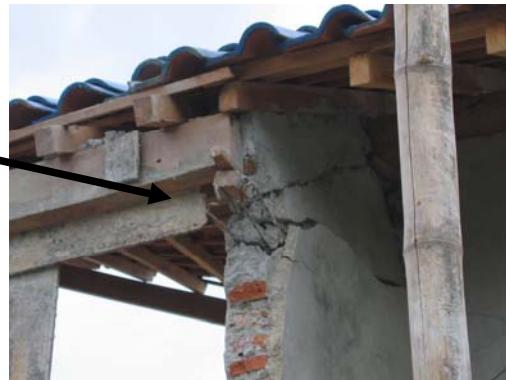
Gambar 14. Tampilan diperbesar dari sambungan ring balok-kolom. IMG_6577
