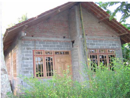
Gambar 20. Kerusakan ringan pada tombak layar (offset gable), Gantiwarno (Klaten), S7.75485° E110.53555°, IMG_6905
