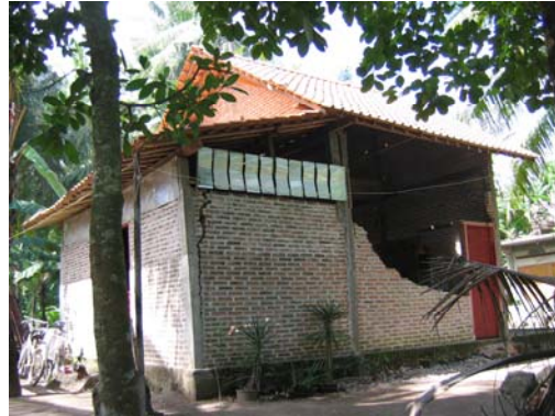
Gambar 23. Dinding pasangan bata yang runtuh (perhatikan tidak adanya ring balok), Kebutren, Pleret (Bantul) S7.86905° E110.40272°, IMG_6725
